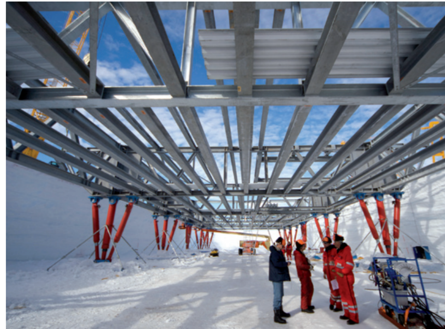
16 hydraulische Hebevorrichtungen verhindern, dass die Station im Schnee versinkt
